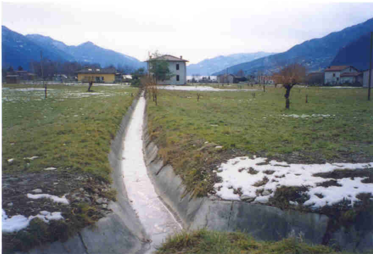
Foto n°7 Corso d'acqua D – Canalette prefabbricate in calcestruzzo
